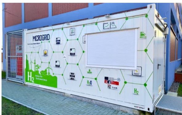
Am Haus C der Hochschule Bremerhaven, direkt an der Columbusstraße, steht ein Wasserstoff-Microgrid-Container. Foto: Marc Wagner
